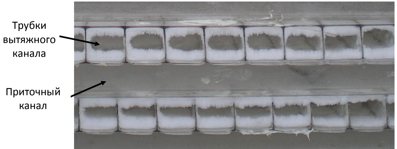
Рисунок 4.8 - Образование инея в вытяжном канале рекуператора на стенке теплообмена, наружная температура - 20 °С
