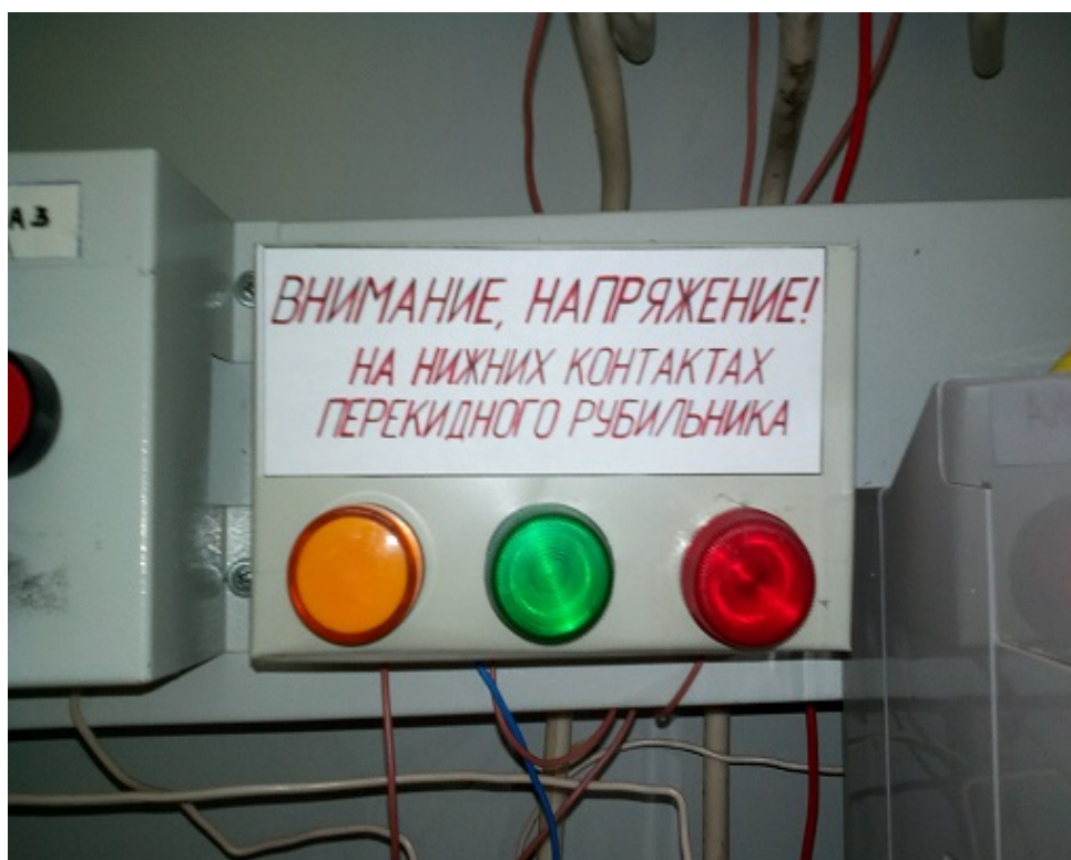
Рисунок 4.30 - Указатель напряжения на обходном шинопроводе.
