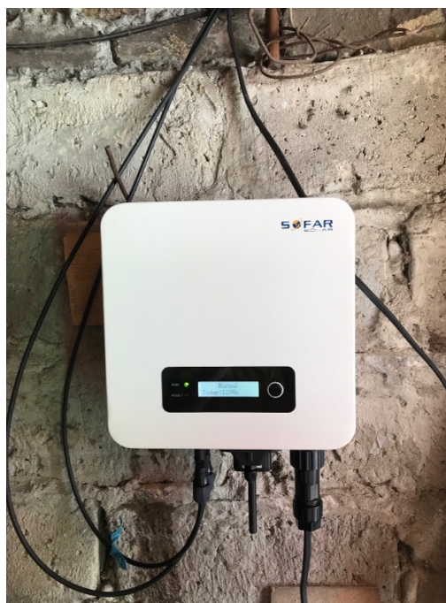
Рисунок 3.3. – Установленный инвертор Sofar
