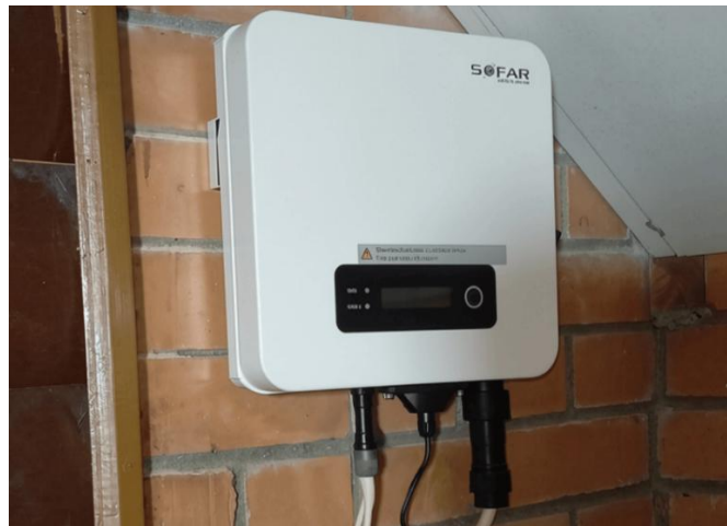
Рисунок 4.12 – Внешний вид установленного сетевого инвертора
