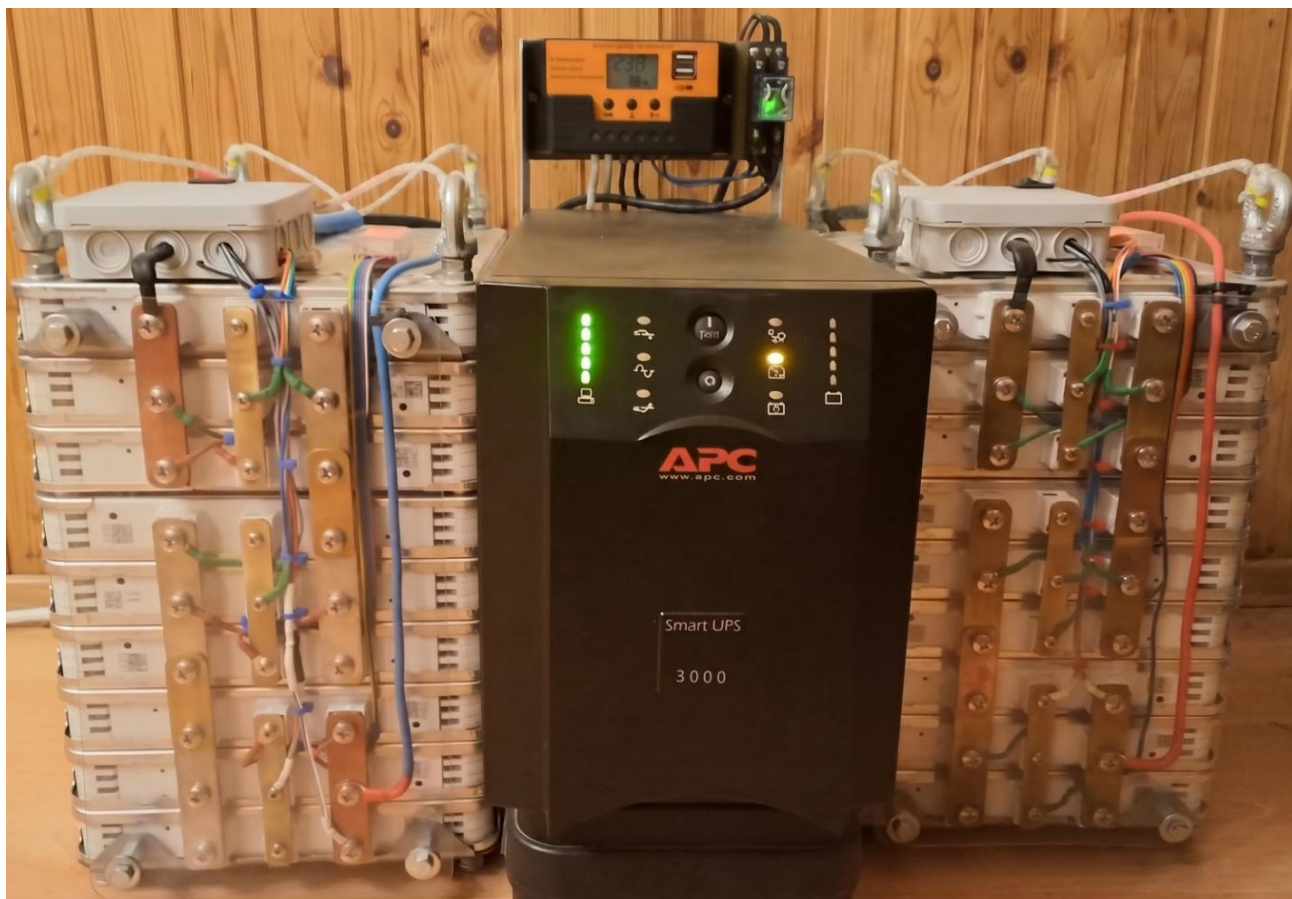
Рисунок 4.15 – Установленный модернизированный источник бесперебойного питания и батареи из аккумуляторных модулей
