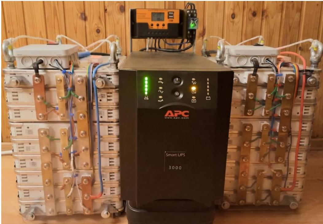
Рисунок 12 – Установленный модернизированный ИБП и батареи из аккумуляторных модулей
