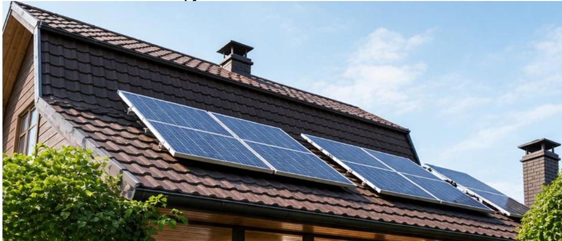
Рисунок 10 – Установленные солнечные панели
