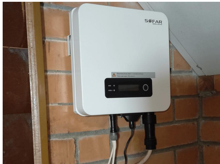
Рисунок 11 – Установленный сетевой инвертор
