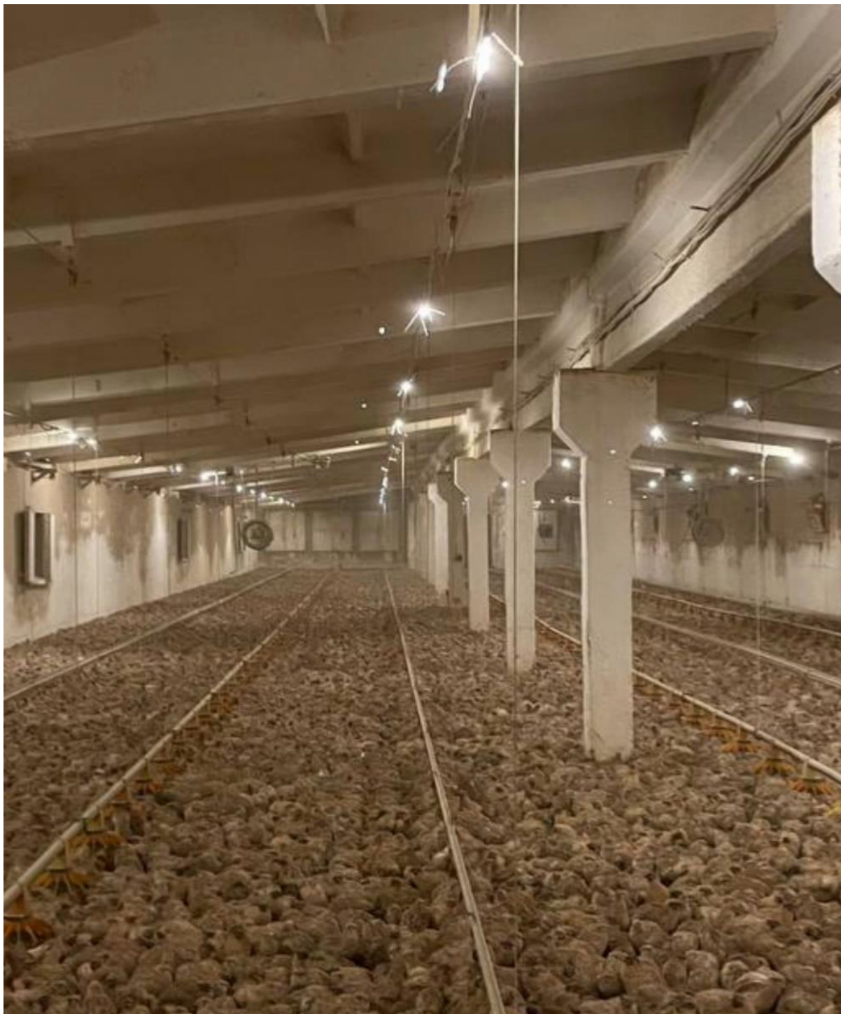
Рисунок 5. Элементы системы вентиляции в помещении для выращивания перепелов на глубокой подстилке
