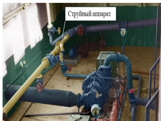
Рисунок 2 – Всасывающий трубопровод насосной станции ООО «Калалинское» Ставропольского края
