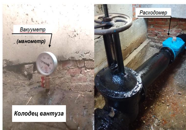
Рисунок 6 – Место установки расходомера и манометра (вакуумметра) в колодце вантуза (1350 м от здания НС-1)
